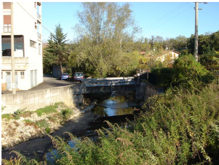
Fig. 32 – Ponte con sezione di deflusso insufficiente a sud di Via Cavalcanti
